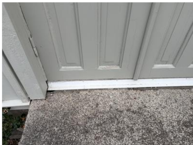
Tröskelplåt täcker bristfälligt över trappa vilket medför ökad risk att vatten tränger in via otätheter till anslutande konstruktioner.
