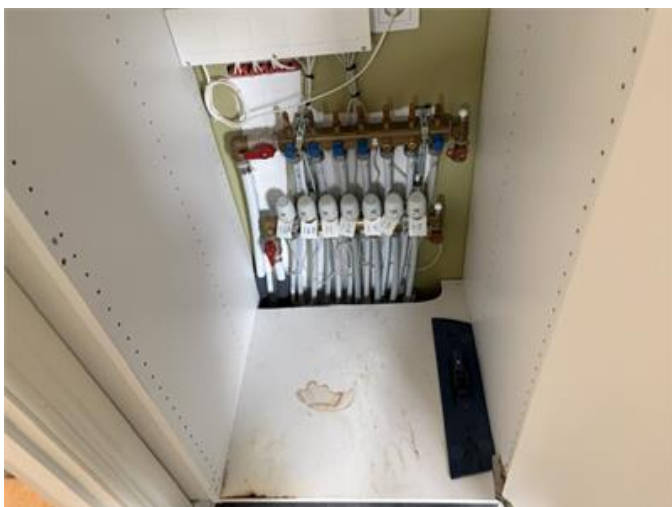
Rör genomföringar i golv förekommer till golvvärmen
