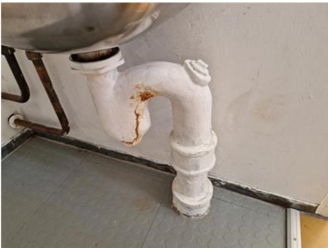
Pannrum: Rostangrepp förekommer på avloppsrör av gjutjärn.
