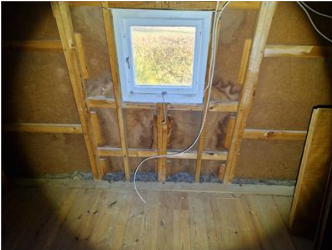
Vind: Fuktfläckar/Formförändringar förekommer på gavlar i anslutning till fönster.
