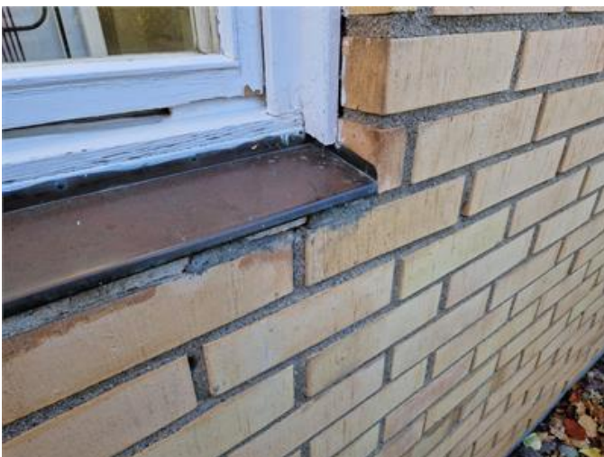
Fönster och Dörrar: Fönsterbleck har delvis för kort överhäng mot fasad
