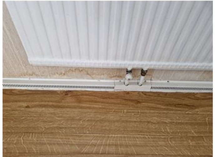
Sovrum 2: Fuktfläckar förekommer på vägg.
