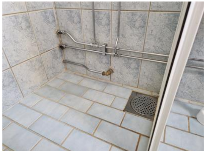
Dusch/Wc/Bastu: Rörngömsföringar i vägg förekommer i duschzon.
