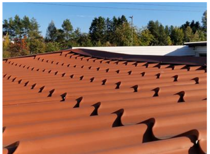
Garage: Takplåten/taknocken delvis skev.
