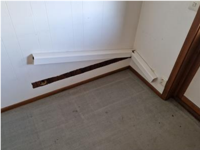
Sovrum 1: Installationer för luft/luftvärmepump förekommer
