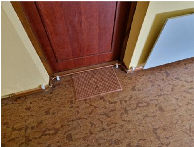
Groventré: Olämplig rördragning
