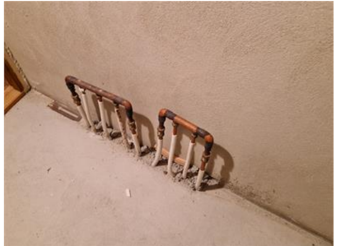
Förråd 2: Vatteninstallationer ej klamrade och ej skyddade
