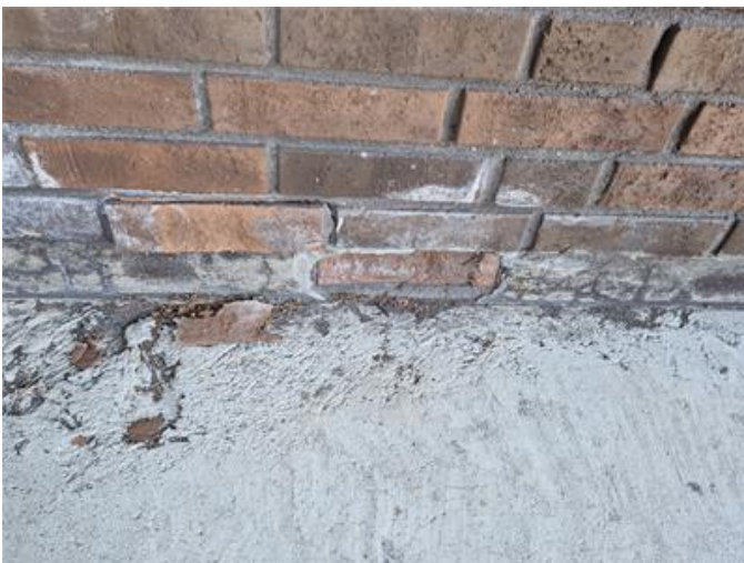
Fasad: Trasigt/Vittrat tegel noterades lokalt
