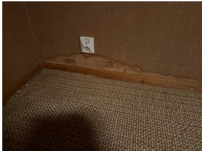
Fläckar på vägg i gillestugan.
