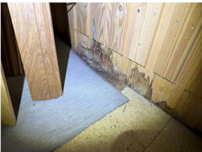
Fuktgenomslag från dusch på andra sidan vägg.
