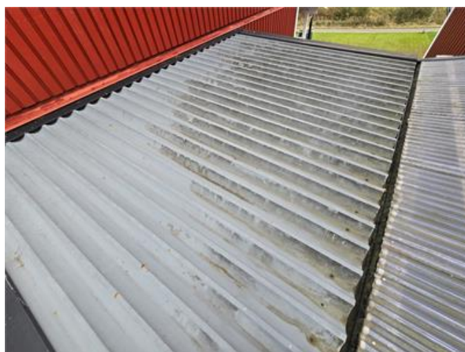
Tak garage: Översiktsbild, äldre plåt med rostanvisningar. Anslutande motfallstak över passage.
