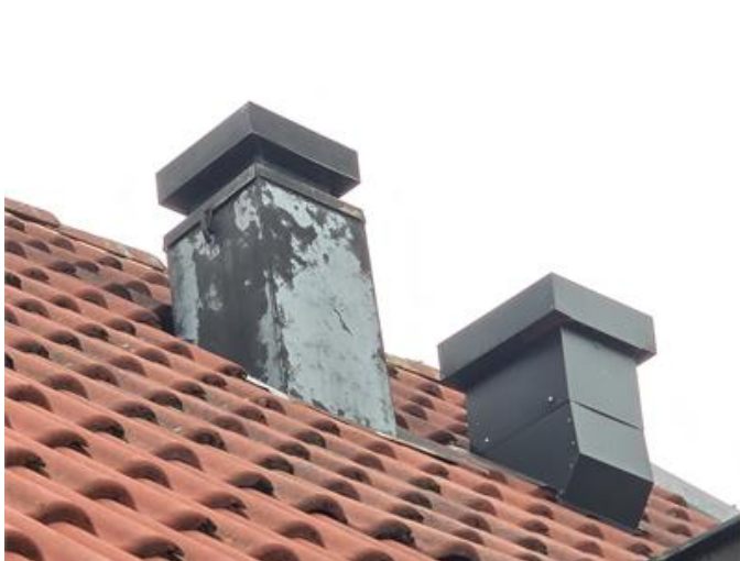
Tak: Exempelbild på äldre huv med färgsläpp/rostanvisningar.
