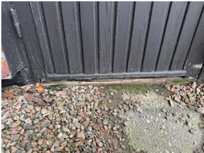
Rötskador förekommer i tröskeln till groventrén.
