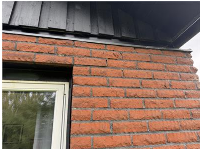
Sprickor förekommer i fogarna på stenfasaden.
