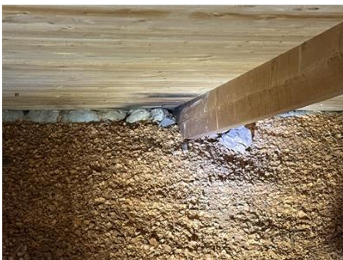
Mikrobiell påväxt förekommer lokalt på underlagstakets insida.
