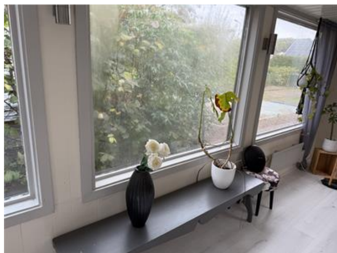
Punkterat isolerglas förekommer i uterummet.
