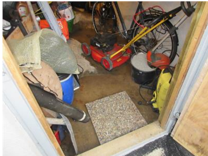
Vattenansamling på mark i förråd
