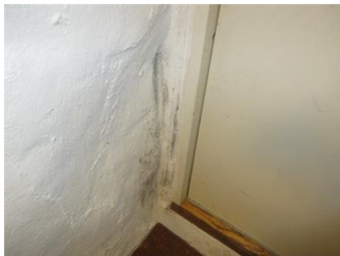
Missfärgningar på yttervägg/karm källare
