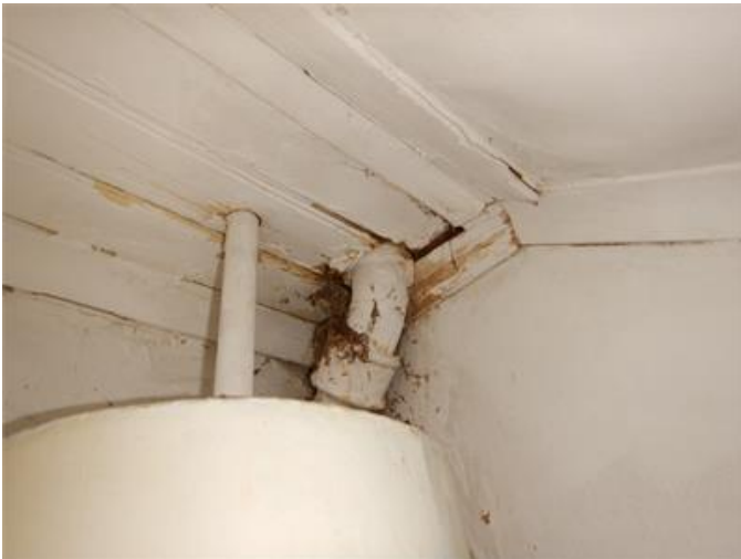
Missfärgning och skador omkring genomföring av expansionskärl och avloppsluftning.
