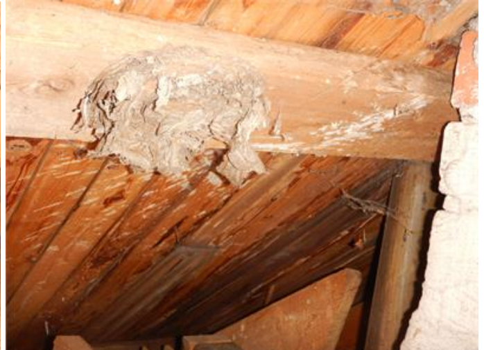
Missfärgning efter tidigare läckage omkring genomföringar av avloppsluftning och expansionskärl.
