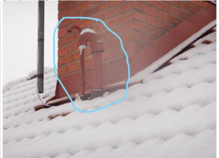
Genomföringar av expansionskärl och avloppsluftning på tak.
