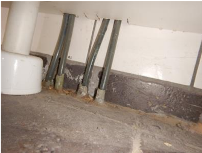
Rör genomföringar i golvet under handfat i badrum.
