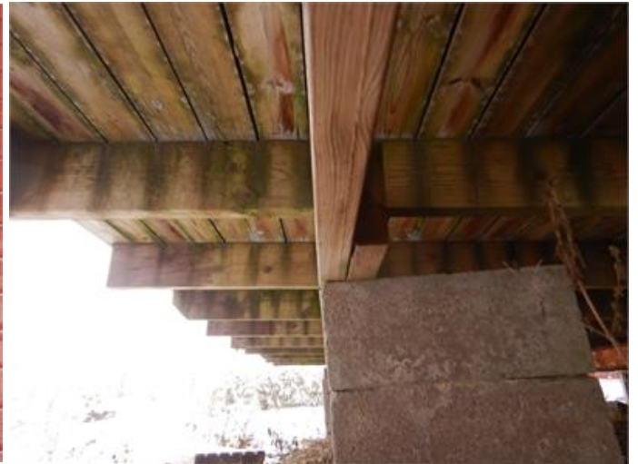
Ojämn belastning av plintar under altan. Plintarna lutar svagt.
