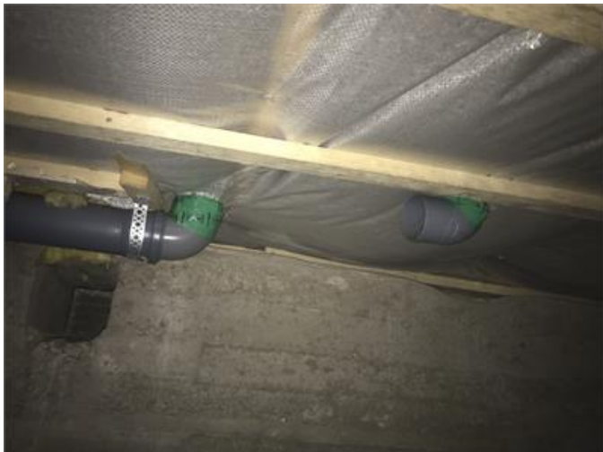
Golvbrunn som ej är ansluten till avloppet.
