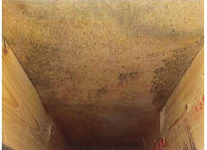
Missfärgningar på underlagstak
