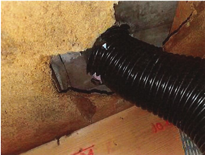
Avloppsavluftningen är otät
