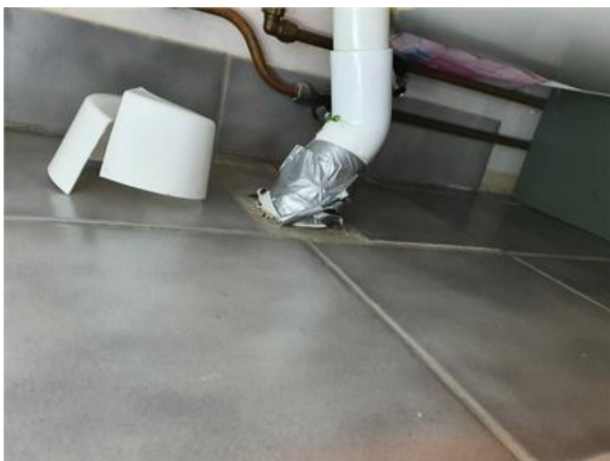
Wc: Avloppsstos till handfatets avlopp är ej tillräckligt uppdraget över golvnivå och har bristfällig tätning.
