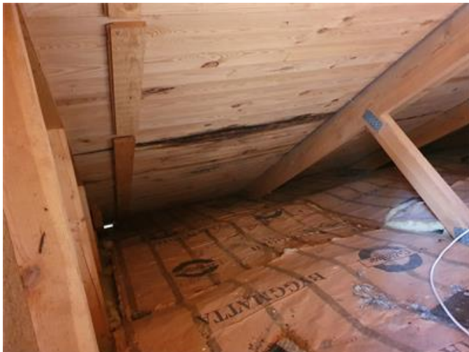
Vind: Fuktfäckor/missfärgningar förekommer i underlagstak.
