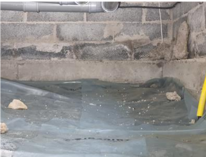
Fuktgenomslag förekommer i grundmurar, vy från krypgrund.
