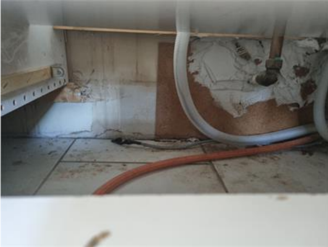
En elkabel med oskyddat avslut noterades under diskbänksskåpet.
