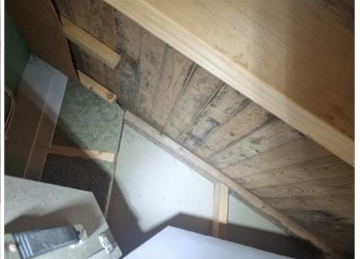
Mikrobiell påväxt noterades på undersidan av underlagstaket.
