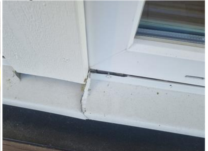
Otättheter noterades i plåtbleckens anslutningar mot karmar och fasad/foder.
