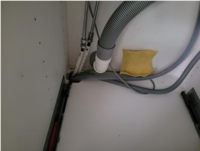
Avsaknad av fuktisolerat hyllplan samt oklamrad avloppslang.
