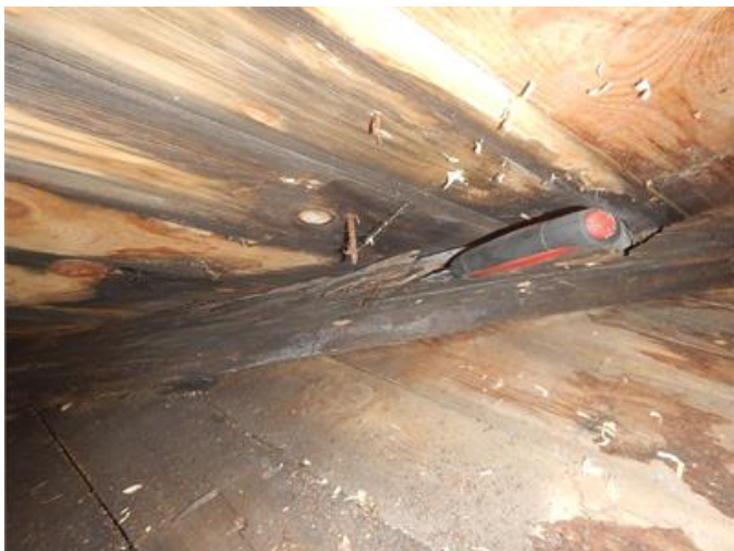
Fuktpåverkan och rötskador på underlagstak vind.
