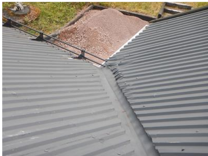
Plåtspikar som krupit ur takplåtar och plåtar som är skadade mot rännal.
