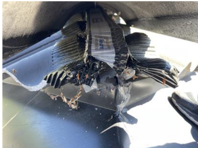
Otät nocktätning i anslutning mot rännadal
