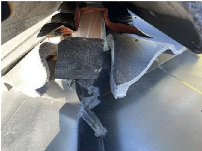
Otät nocktätning i anslutning mot rännadal
