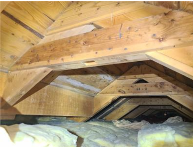
Nockvind, viss mikrobiell påväxt på underlagstaket.
