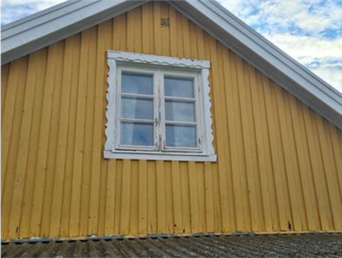
Fasad, södra gaveln har rötskador, bytesbehov.
