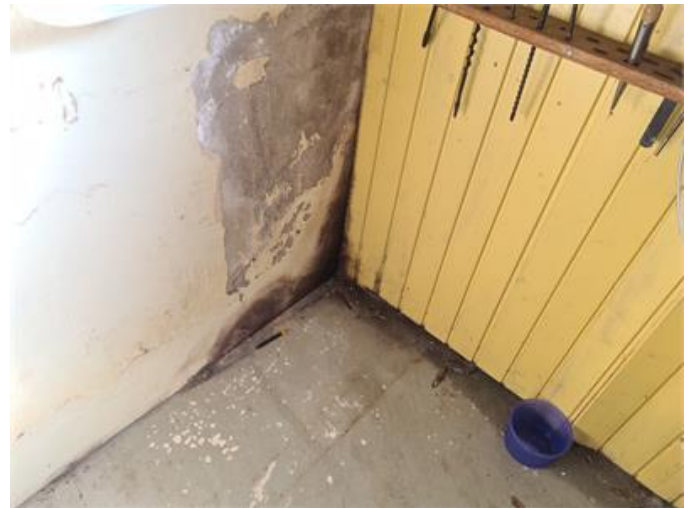
Källare Verkstad, fuktskada i vägg.
