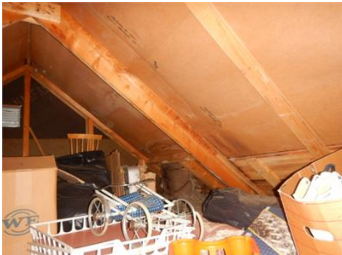
Missfärgning på takskivornockvind.
