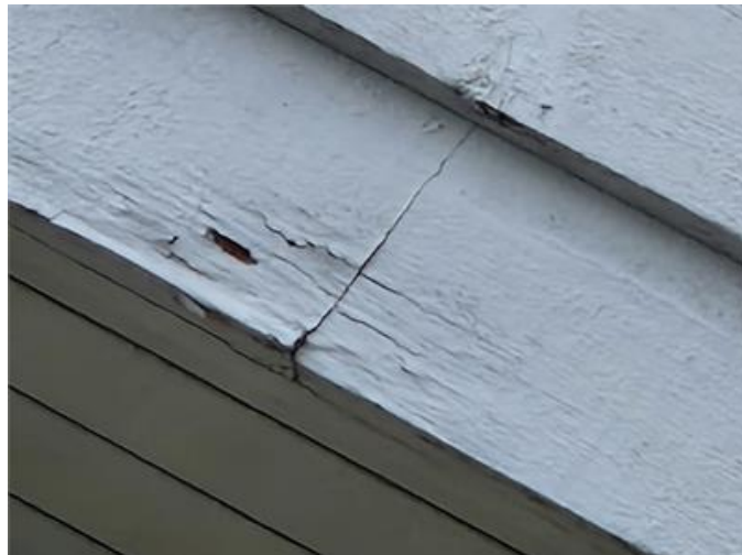
Rötskada vindskiva. - Utvändigt
