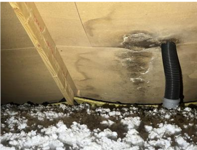
Exempel på fuktfläckar i underlagstaket i vindsutrymmet.
