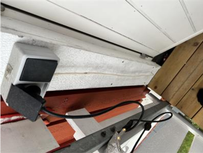
Bristfällig el-installation vid balkong.
