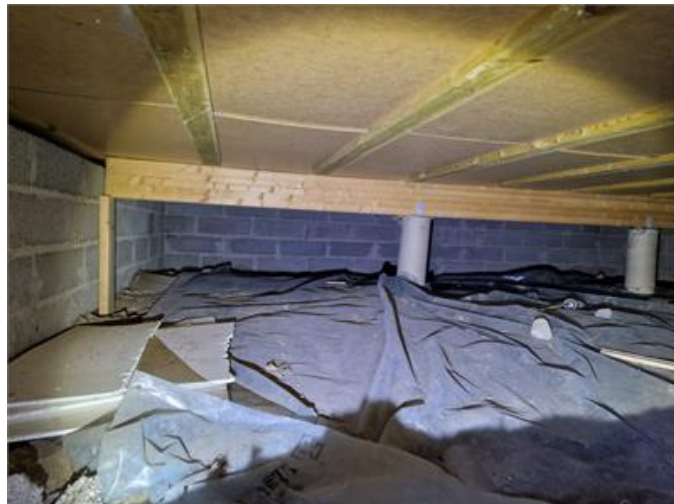
Plast har ett justeringsbehov. -Krypgrund.
