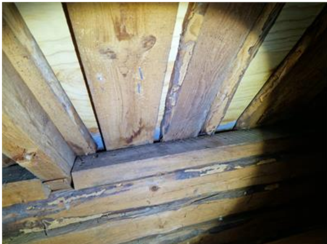
Rimfrost på underlagstak. -Vind.
