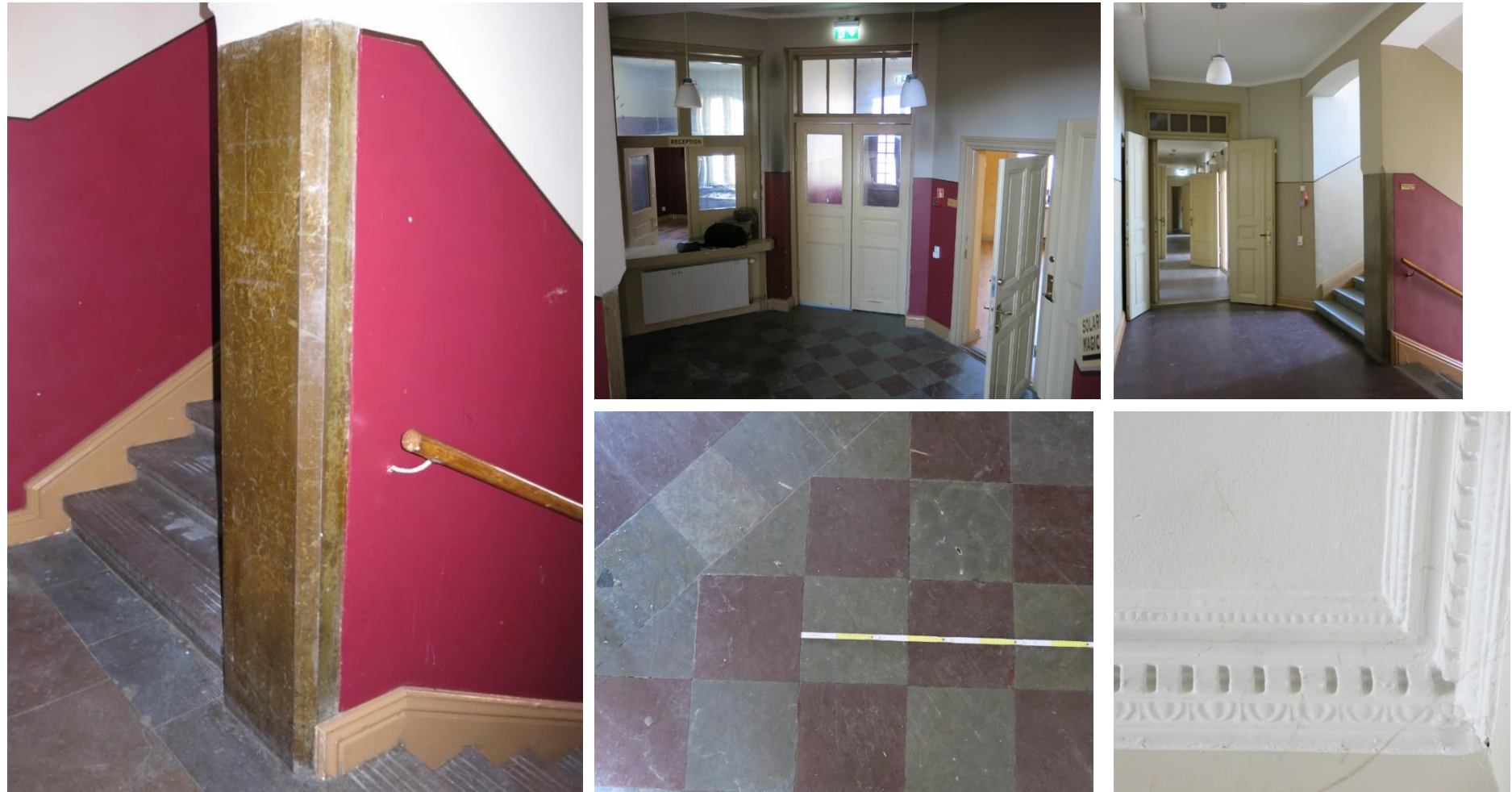
Räfflade trappsteg av kalksten, schackrutiga kalkstengolv, hörnskydd av polerad kalksten finns bevarade i stor utsträckning, liksom golvssocklar, välvda öppningar, fyllningsdörrar och överljus m.m.
