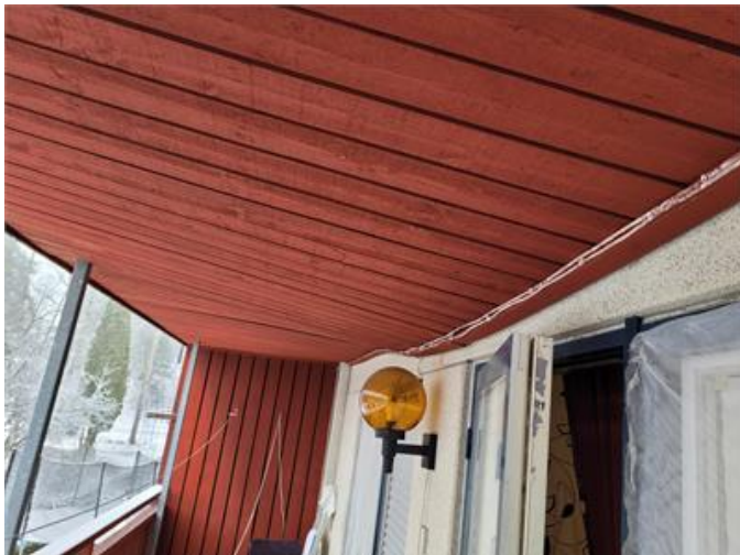
Tak ovan balkong har släppt från sin infästning.
