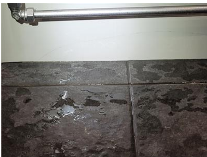
Spricka i kakelplatta i duschzon
