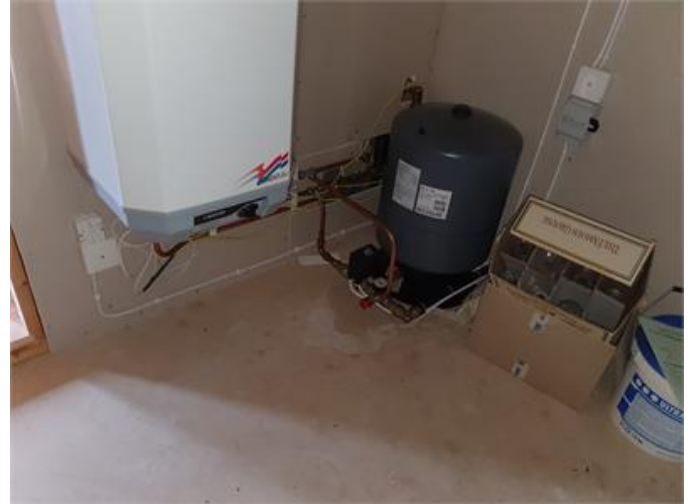
Sidovind 2: Fuktskydd saknas under varmvattenberedare och Hydropress.
