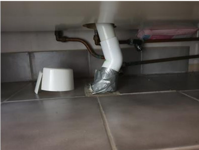
Wc: Avloppsstos till handfatets avlopp är ej tillräckligt uppdraget över golvnivå och har bristfällig tätning.
