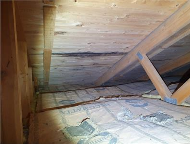
Vind: Fuktfläckar/missfärgningar förekommer i underlagstak.
