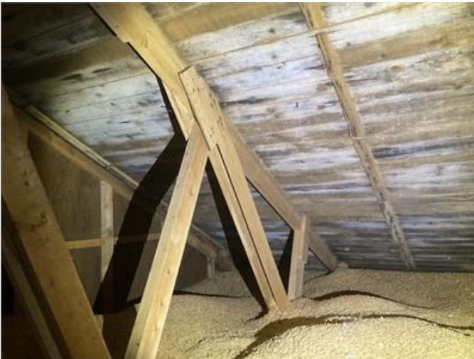
Mikrobiell påväxt på underlagstaket.
