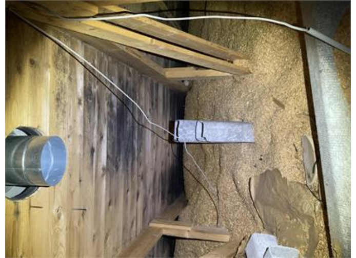
Mynnande ventilationsrör på vind.
