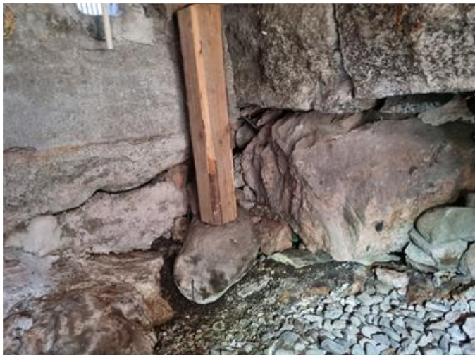
Källare / krypgrund med Fuktkomslag
