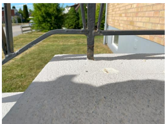
3 skada på trappräcke
