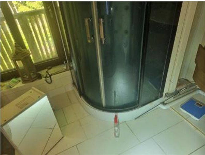
Exempelbild, äldre våtutrymme med spruckna keramikplattor.
