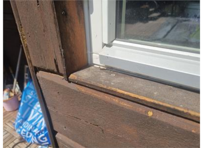
Exempelbild, avsaknad av fönsterbleck.
