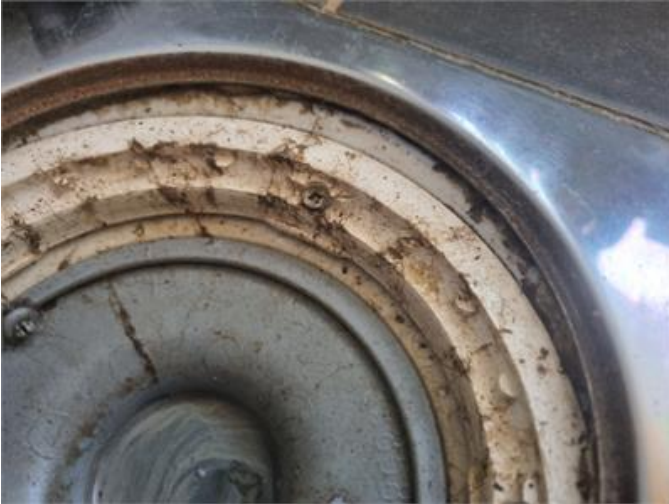
Exempelbild, det finns ingen brunnmanschett i anslutning till golvbrunnen.
