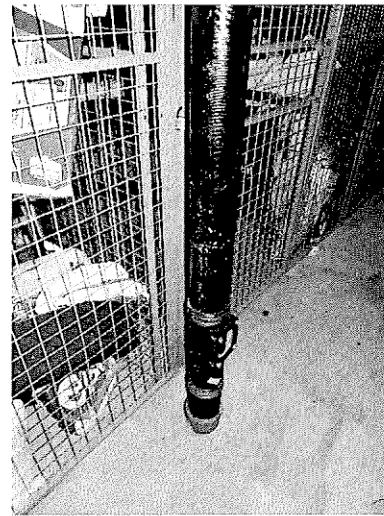
Bild 20 Spillvattenrör av gjutjärn
