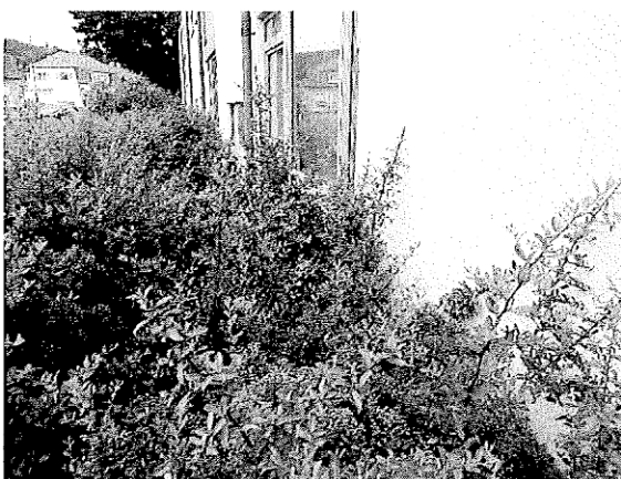
Bild 2 Växtlighet mot fasad
