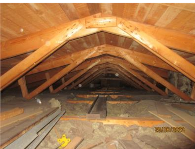
Vinden endast besiktningbar från lucka då landgångar saknas.
