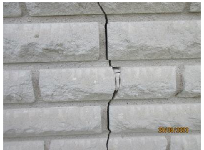
Spricka i tegelfasad.
