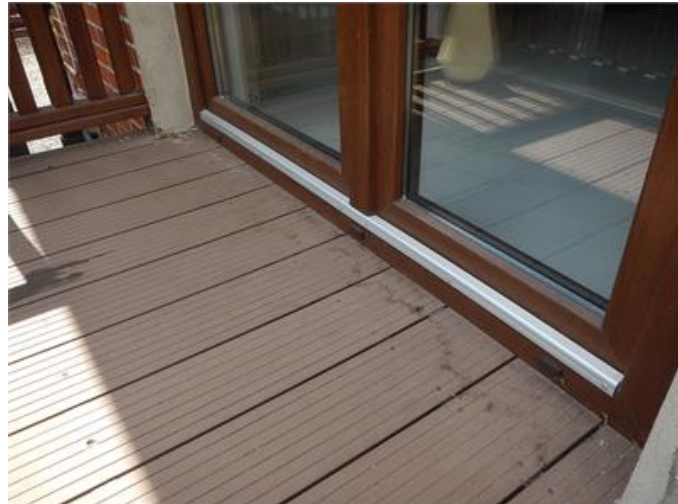
Ingen tröskelplåt på altandörren.
