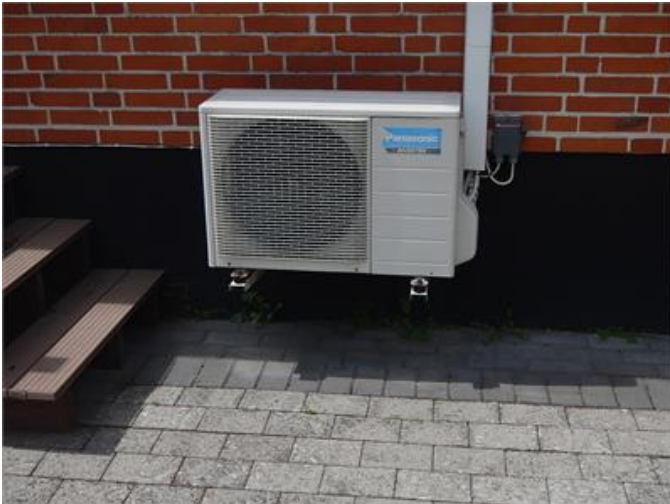
Inget droppskydd under luftvärmepumpen.
