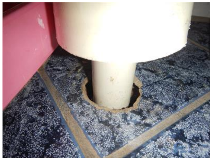
Otättheter runt vaskens avloppsrör i "Dusch-WC".
