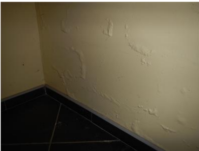
Fuktgenomslag på källaryttervägg.
