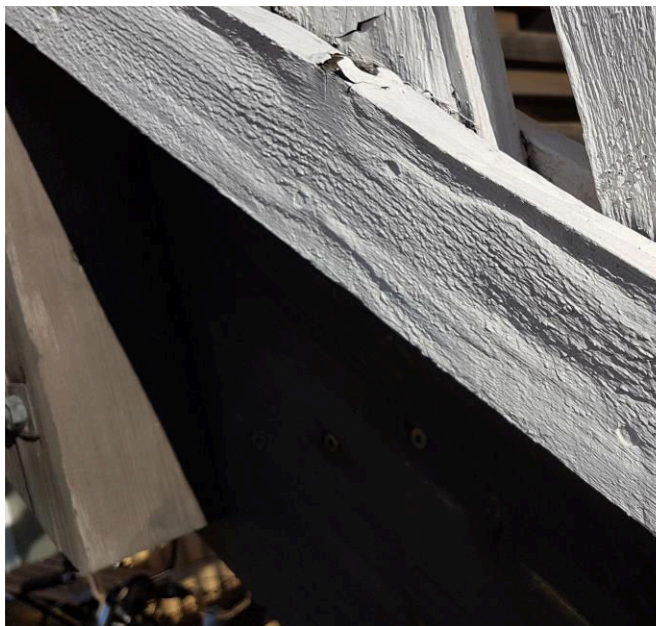
Rötskadad räckesdel till utvändiga trappor.
