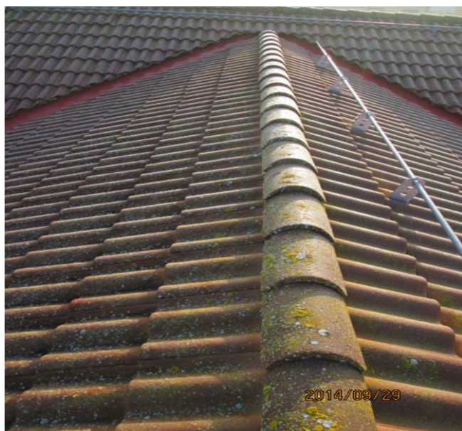
Taknock med algpåväxt
