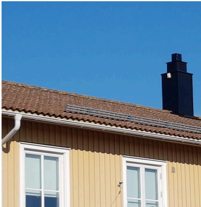
Taköversikt med spruckna pannor
