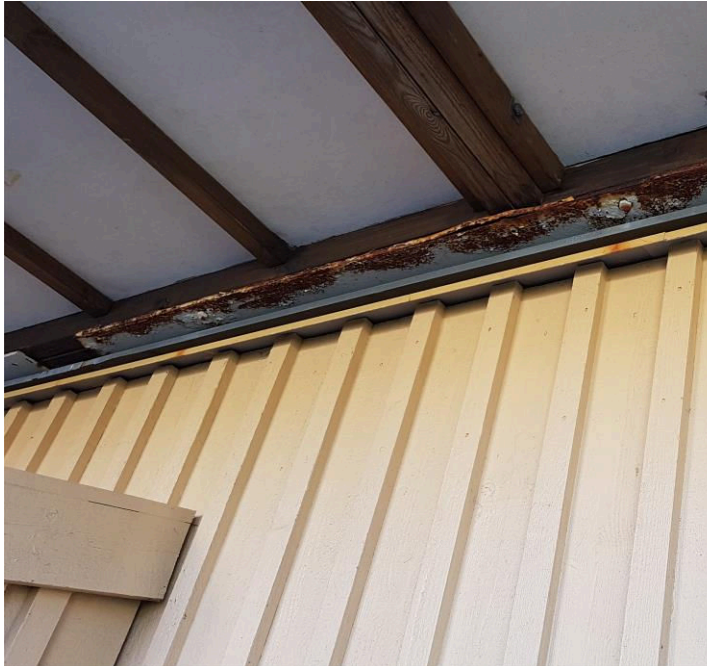
Rostangripen stål balk till loftgång.
