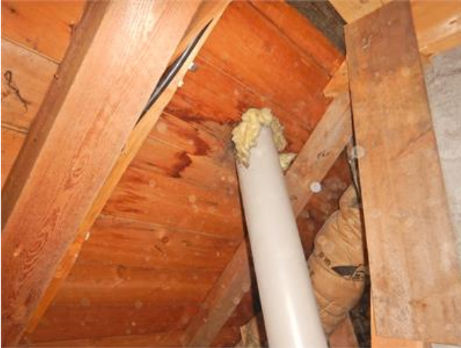
Mindre missfärgning omkring genomföring.
