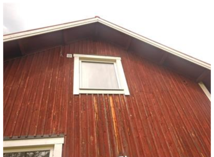
Underhålls behov av fasad
