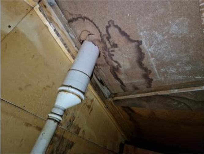
Fuktfäckor på underlagstakets board. - Vind
