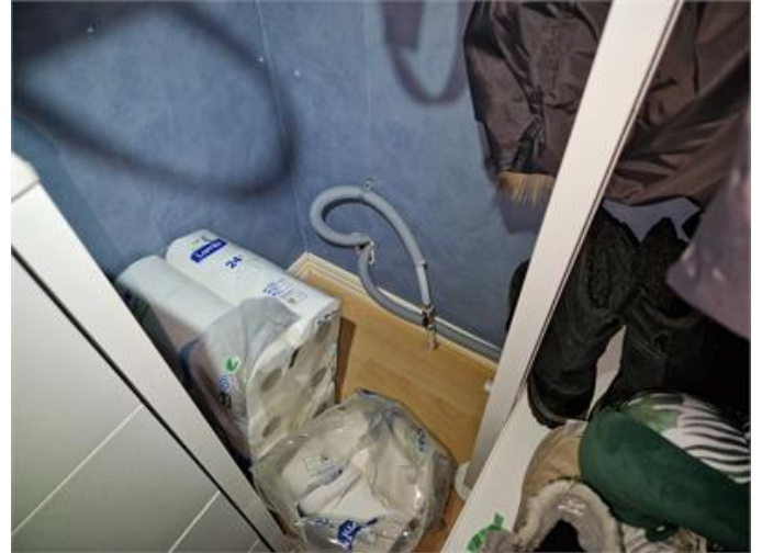
Koppling på tappvatten utan fuktsäkerhet. - Klädkammare
