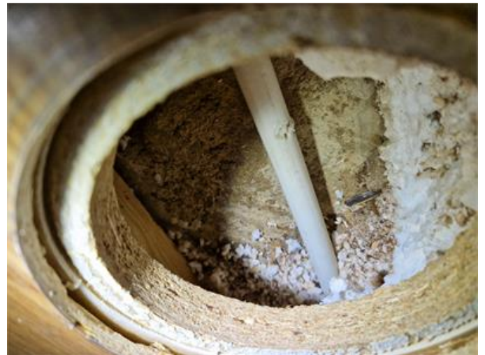
Åverkan på plast och isolering i golv. - Kök.
