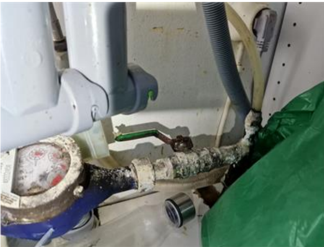
Ärgningar på vattenmätare. - Kök
