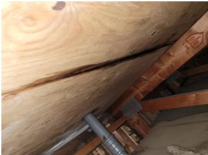
Läckage i yttertak noterades.
