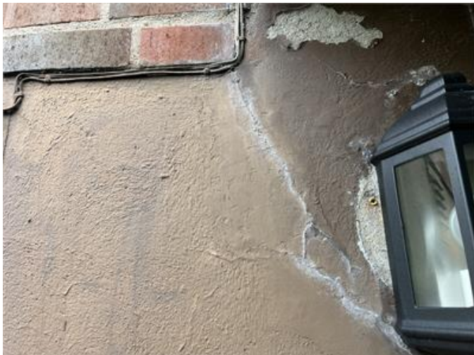
Sockel, sprickor noterades i sockel.
