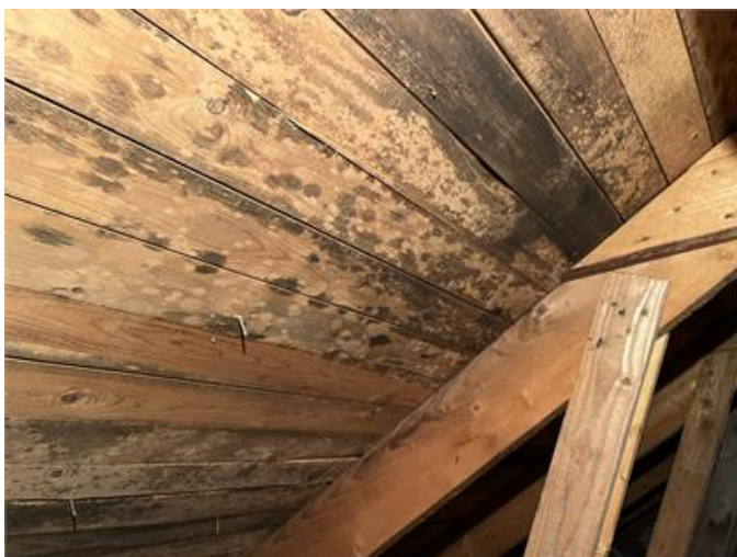
Nockvind, mikrobiell påväxt på underlagstaket.
