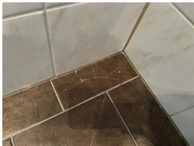
Dusch/Wc, sprucken platta i duschzonen.
