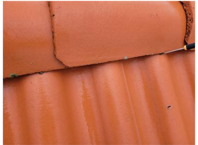
Nocktätning saknas, synliga infästningshål förekommer
