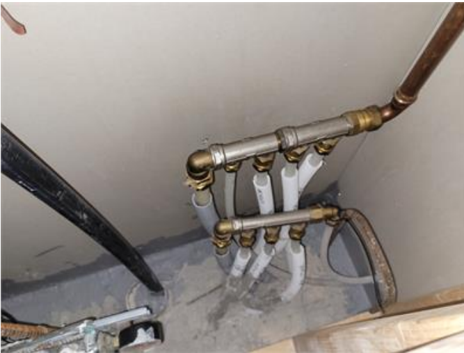
Kopplingskåp saknar fuktskydd
