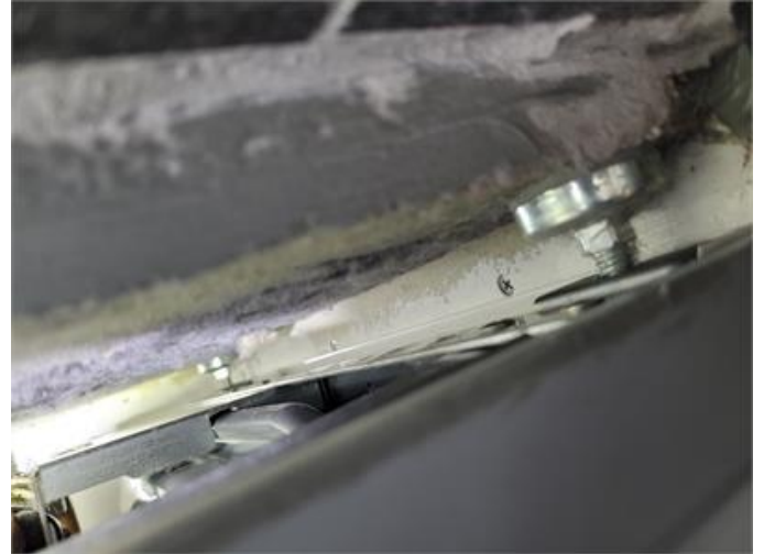
Tätskikt saknas på vägg bakom värmepump
