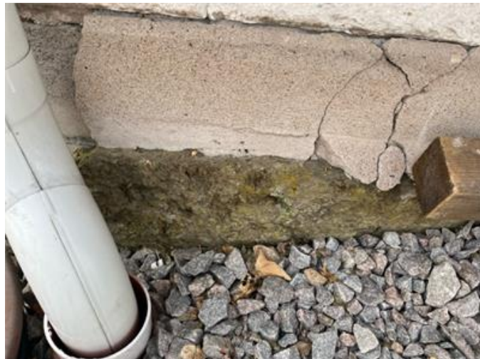
Del av det utvändiga fuktskyddet ligger synligt ovan marknivå och bör täckas för och tätas vid ovankant där puts lossnat.
