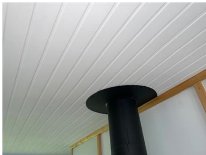
Tak böjer ned/bågner lokalt vid skorsten.
