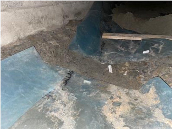
Kondensskydd på mark är bristfälligt i krypgrunden.
