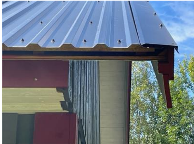
Takfotsplåt saknas och takfotsbräda saknas på delar.
