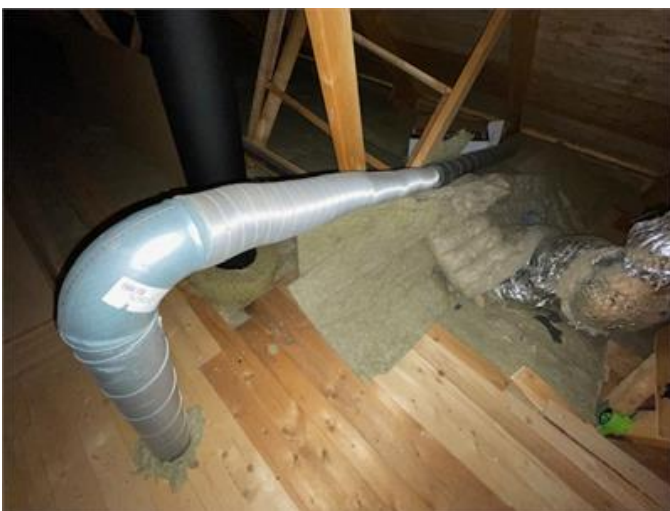
Rör kommer upp genom vindsbjälklaget och avslutas på vind.
