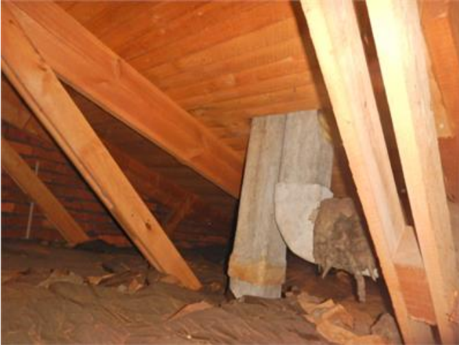
Oisolerade ventilationskanaler på vinden.
