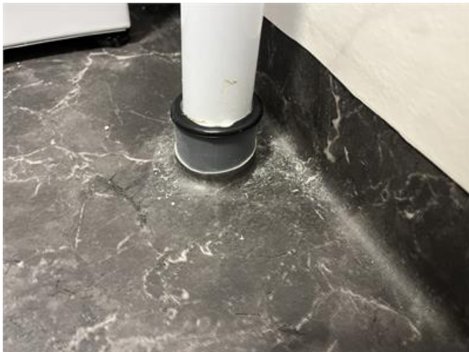
Dusch/WC/Tvättstuga, avloppsstos är placerad för nära väggen.
