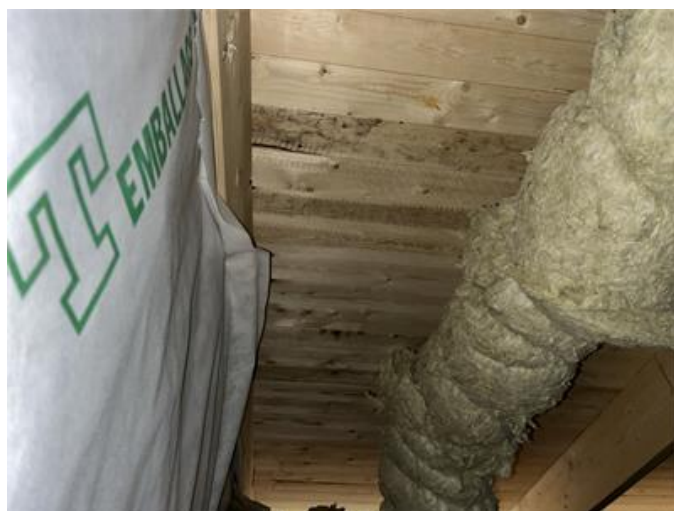
Vindsutrymme, lokal mikrobiell påväxt noterades på enstaka brädor i underlagstaket.
