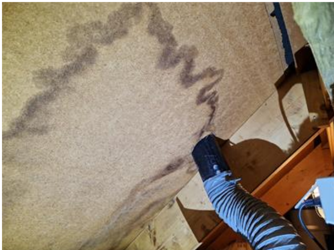
Sidovind 1-2: Fuktfläckar förekommer på masonitskivor i underlagstak på sidovind 2
