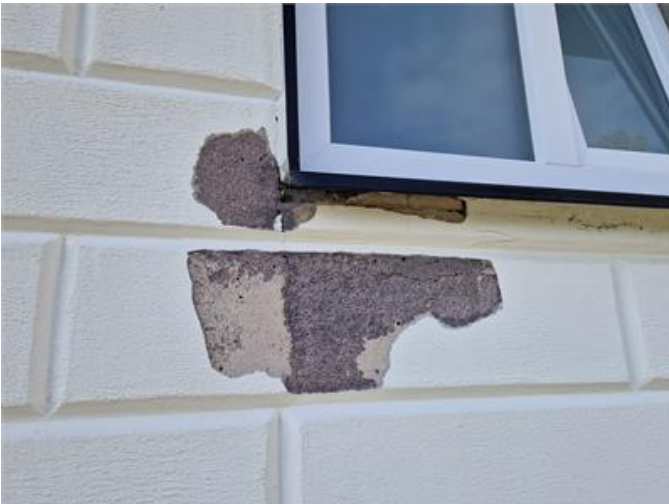
Fasad och Sockel: Skador förekommer i fasadsten.
