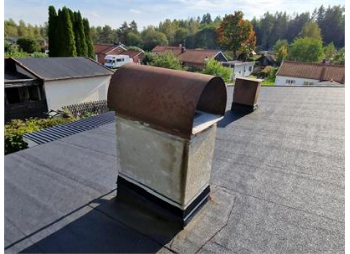
Tak: Rostangrepp på skorstenshuv.
