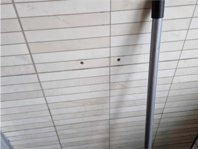
Dusch/Wc: Tätade skruvhål och sprickor i kakel förekommer i duschzon.
