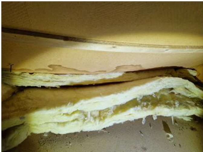
Sisovind: Fuktfläckar noterades på masonitskiva i underlagstak
