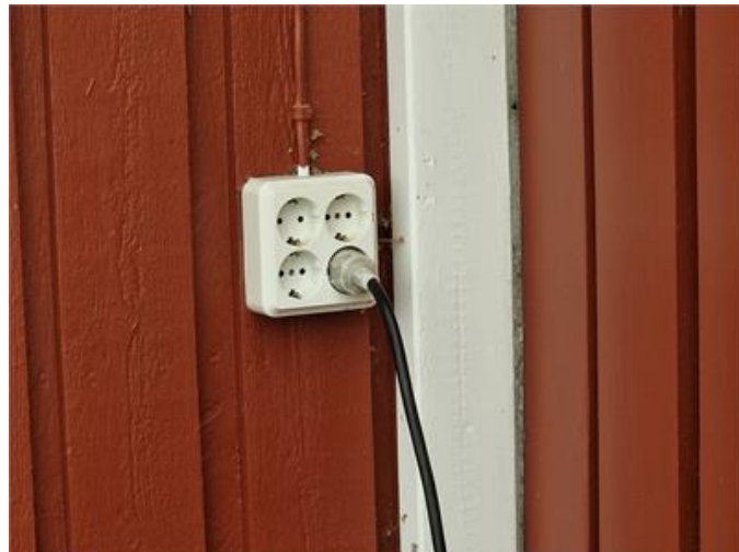
Fasad: Eluttag på altan anses ej vara avsett för utomhusbruk.
