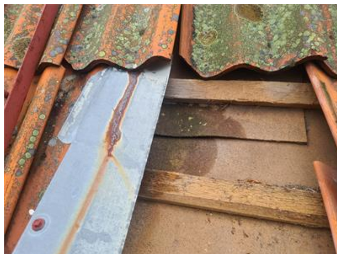
Tak, fuktskada vid vattplåt taklyft framsida.
