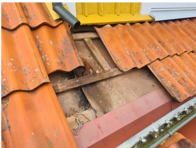
Tak, fuktskada nedan taklyft framsida.
