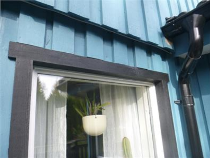
Bilden visar exempel på fönster där plåtdetalj inte finns ovan fönstret.
