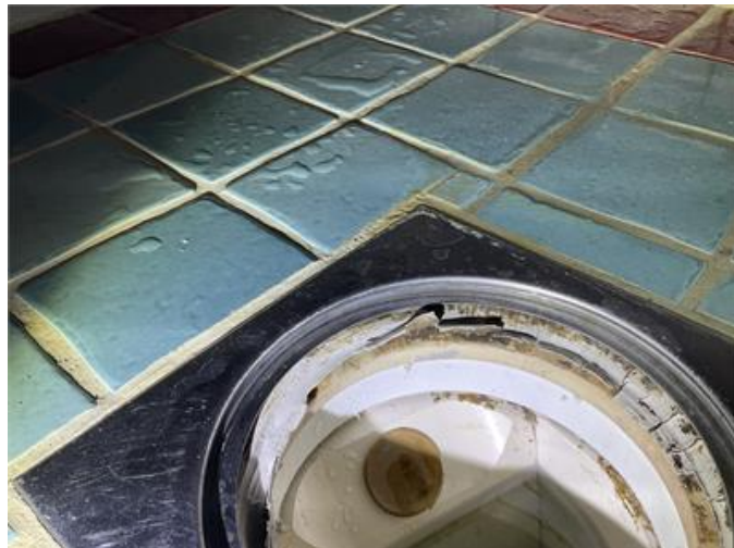
Otät tätskikt ovan klämring till duschens golvbrunn.
