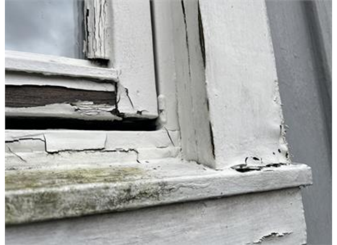
Fönster, underhåll/målningsbehov och lokala rötskador i foder.
