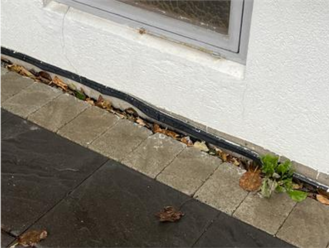
Mark, äldre fuktskydd/dränering där fuktskyddsmattan har släppt från täcklisten.
