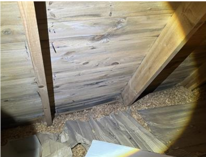
Nockvind, mikrobiell påväxt på underlagstaket.
