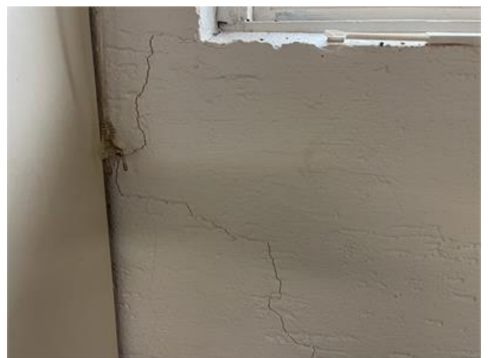
Hela huset/Allmänt, sprickor noterades i väggar i källaren in-och utvändigt
