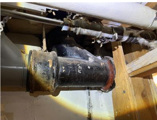
VA. äldre VA-installationer.
