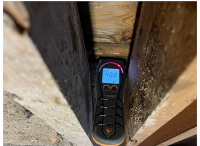
Nockvind, fuktmätning i underlagstaket vid murstocken med förhöjda fuktvärden.
