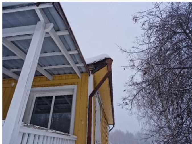
Takavvattning har brister.
