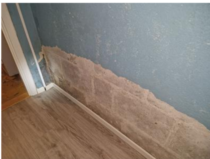
Källare puts och färgsläpp noteras.
