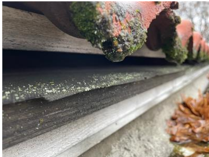
Takfotsplåt ej monterad.
