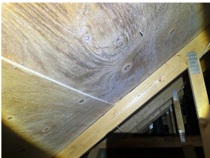
Nockvind, mikrobiell påväxt på underlagstaket.
