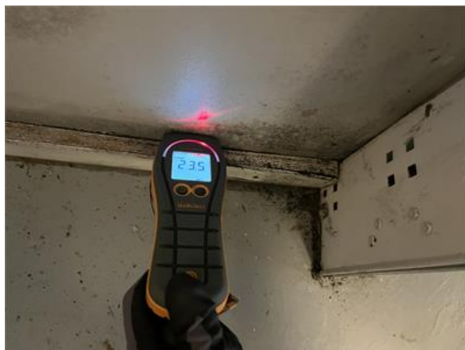
Garage/Invändigt, mikrobiell påväxt och förhöjda fuktvärden.
