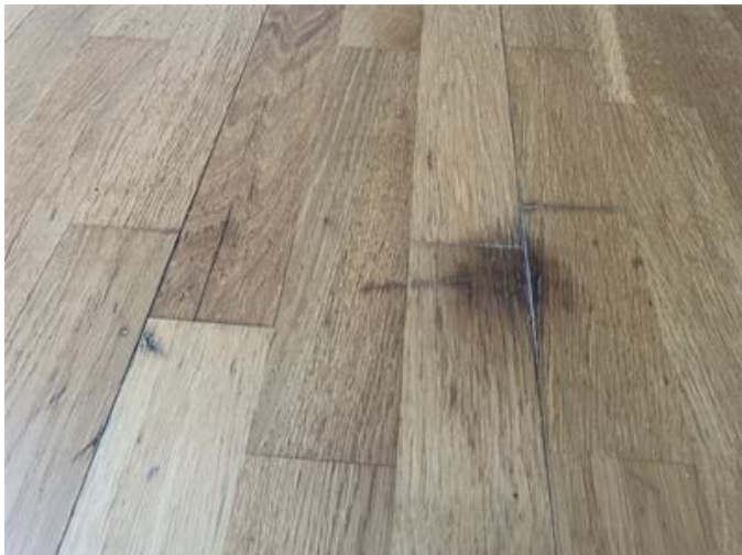
Sovrum4, missfärgningar och lokala resningar i golvet.
